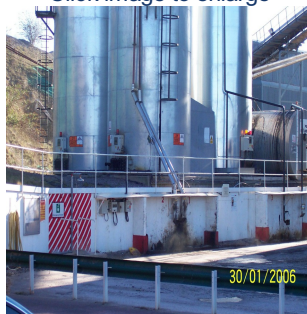
Bitumen discharge area
