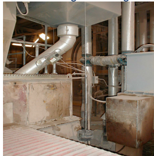
Bitumen discharge area
